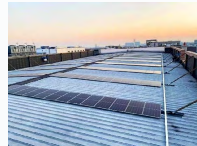
博兴数据中心光伏项目
