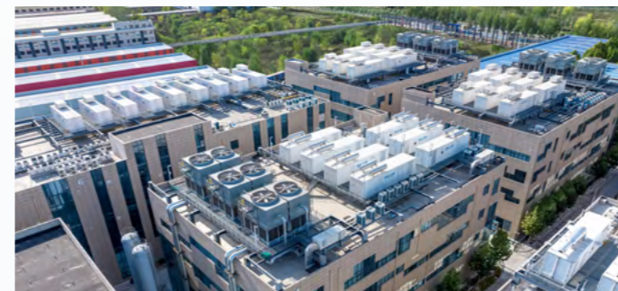
三河铭泰绿色数据中心鸟瞰图 Aerial view of Sanhe Mingtai Green Data Center
